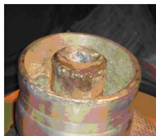
图2. 运行中检出xx变电站330kvGIS GM24气室 A 相母线连接触头严重过热故障
