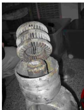
图5.运行中检出 xx 变电站 330kvGISGB1气室 B 相母线连接梅花触头严重过热故障
